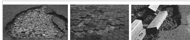
Выбоины выпадение плитки разрушения
